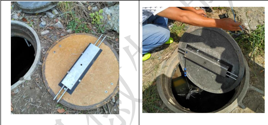
井盖电控锁的安装（上海电力）
